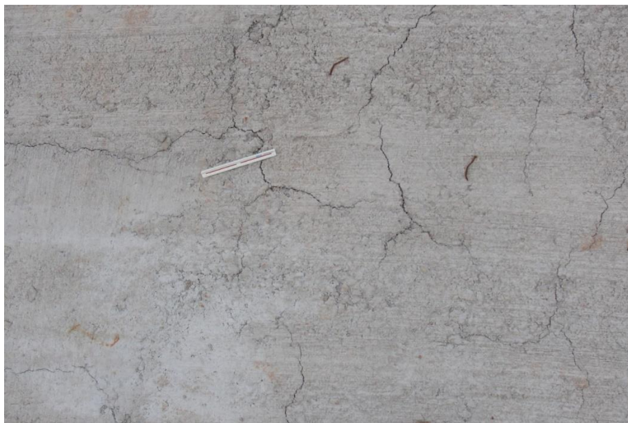
Figura 34 - Fissuração Devido ao Calor de Hidratação
