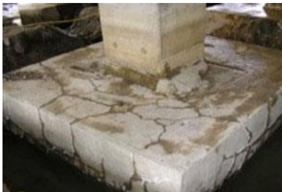
Figura 38 - Fissuração Devido a Reação Álcali-Agregado
