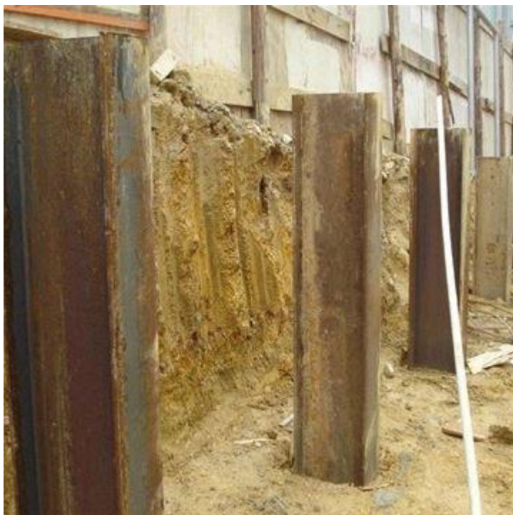
Figura 39 - Corrosão Estaca Metálica
