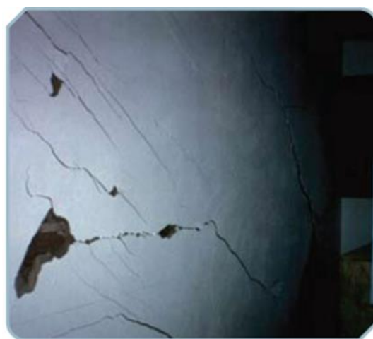
Figura 49 - Fissuras na Alvenaria.
