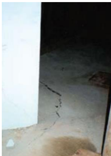
Figura 55 - Fissuras Próximas ao Pilar 33.
