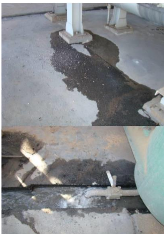
Figura 64 - Vazamento na Canaleta de Escoamento de Água na Área da Caldeira
