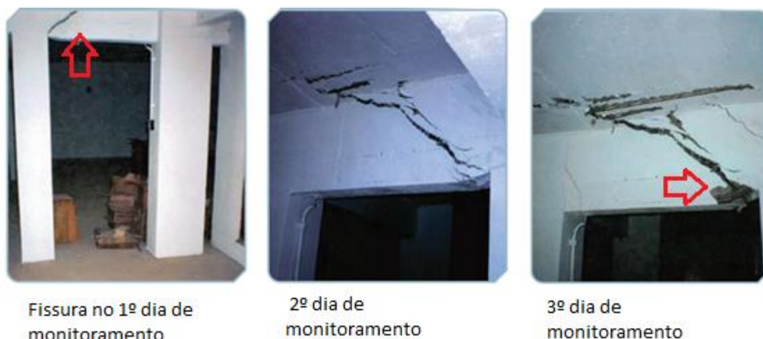
Figura 51 - Evolução da Fissura na Viga VY4
