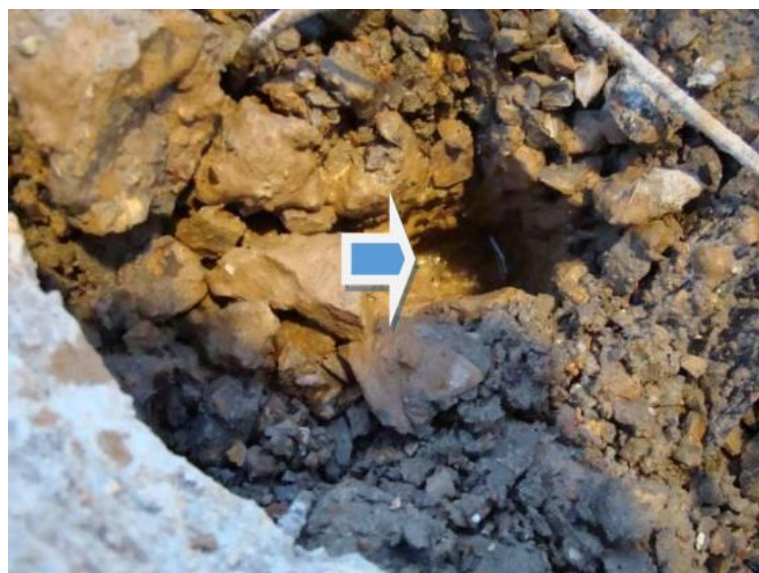
Figura 65 - Água Acumulada na Área da Caldeira
