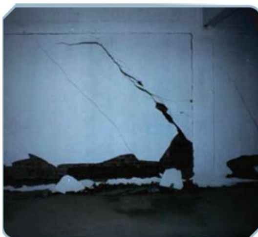
Figura 48 - Fissuras na Alvenaria.
