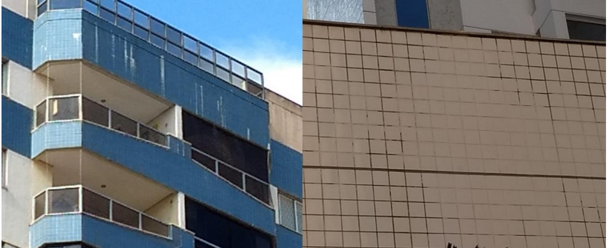
Figura 10 Eflorescência: carbonato de cálcio e bolor em RCF.
