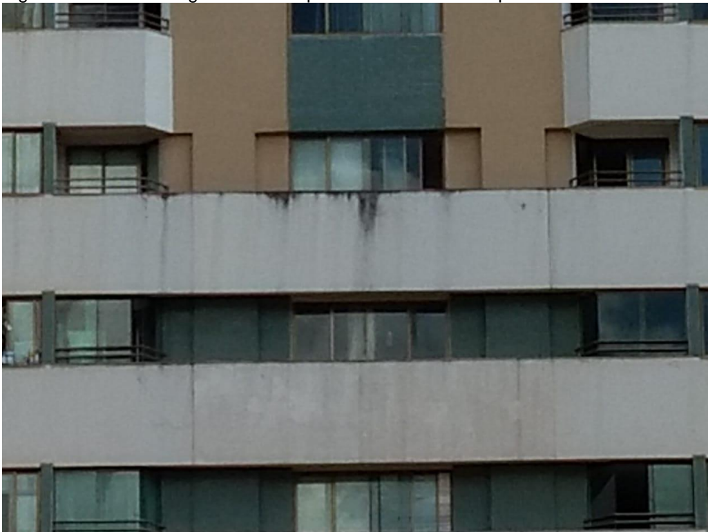
Figura 12 – mostra fungos causados por umidade causadas pela chuva.
