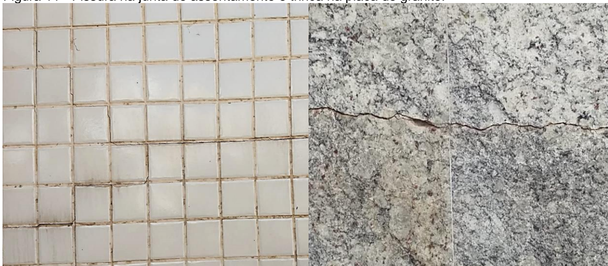
Figura 11 - Fissura na junta de assentamento e trinca na placa de granito.
