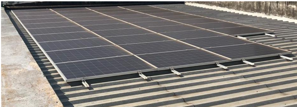
Figura 5-16: Sistema solar fotovoltaico do UniCEUB campus Asa Norte (lado direito).
