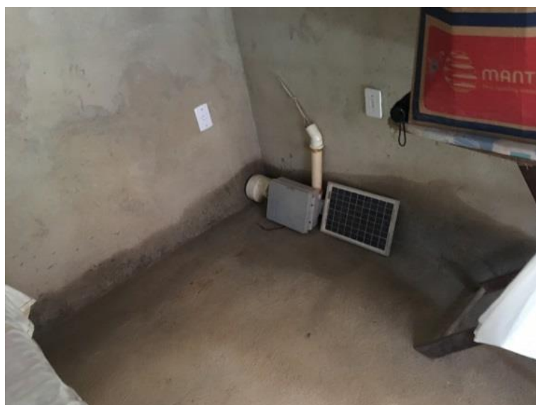
Figura 130 – Umidade no quarto filho após a Assistência Técnica
