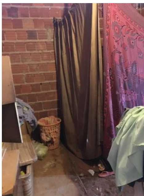
Figura 67 – Vista 2: Banheiro improvisado por lençóis na casa do Alcino
