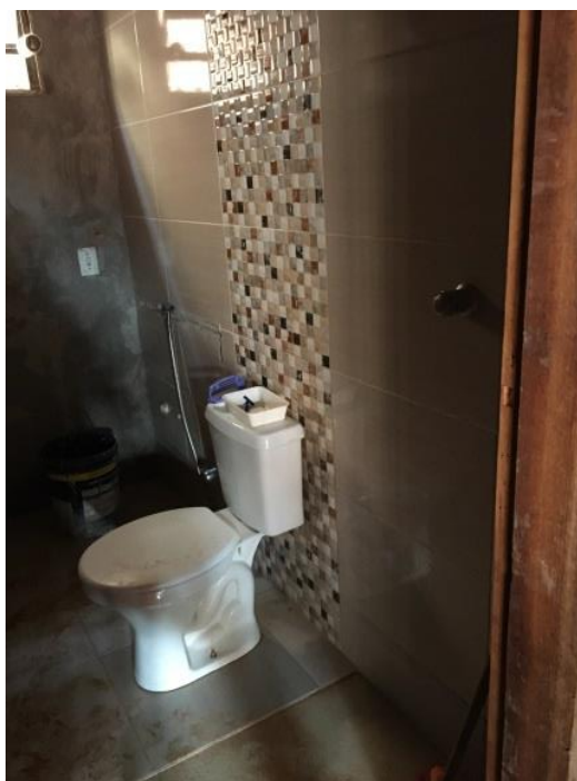
Figura 114 - Novo acesso ao banheiro da casa do Valderi após a Assistência Técnica
