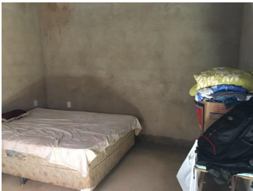
Figura 131 – Vista 9: Umidade no quarto do filho após a Assistência Técnica
