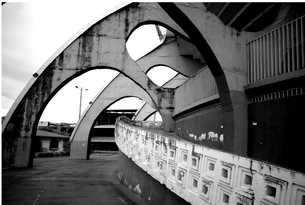
Figura14. Rampa y soportes del Coliseo Mayor Jefferson Pérez.
