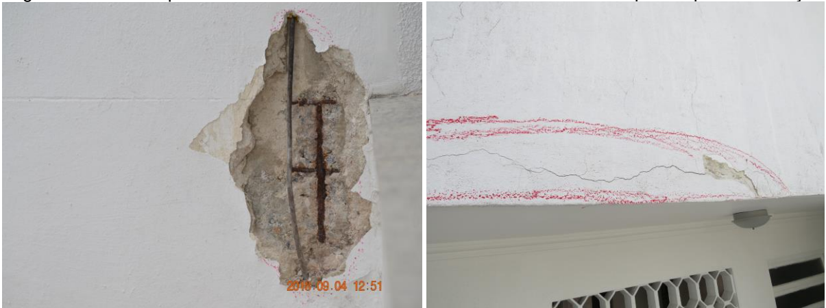
Figura 9 e 10 – Deslocamento e corrosão da armadura e fissuras causadas pela expansão do aço.
