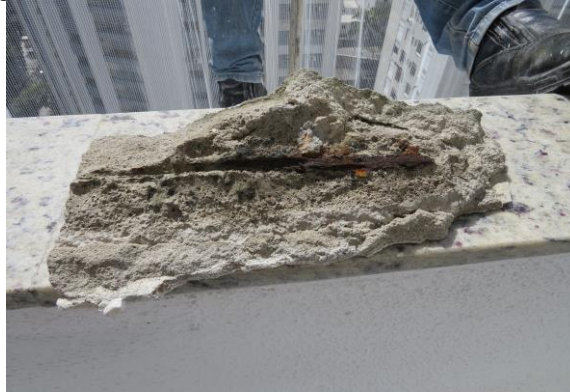
Figura 13 – Deslocamento e perda da seção do aço.
