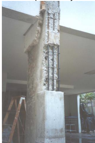
Figura 29 – Aparência final após remoção das áreas degradadas.
