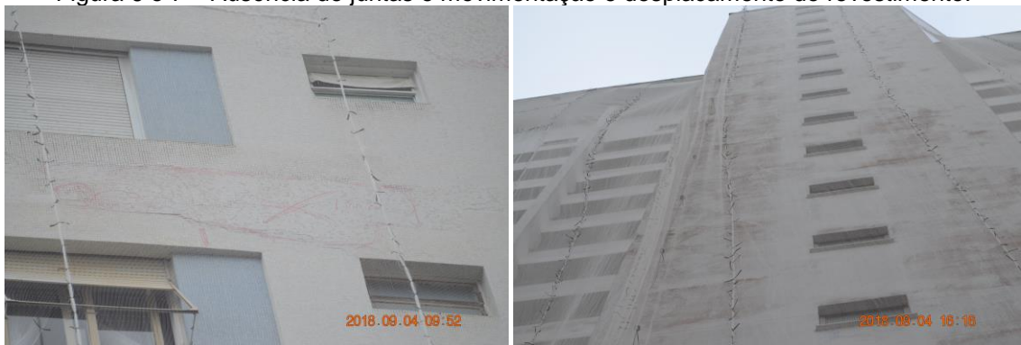
Figura 6 e 7 – Ausência de juntas e movimentação e deslocamento do revestimento.
