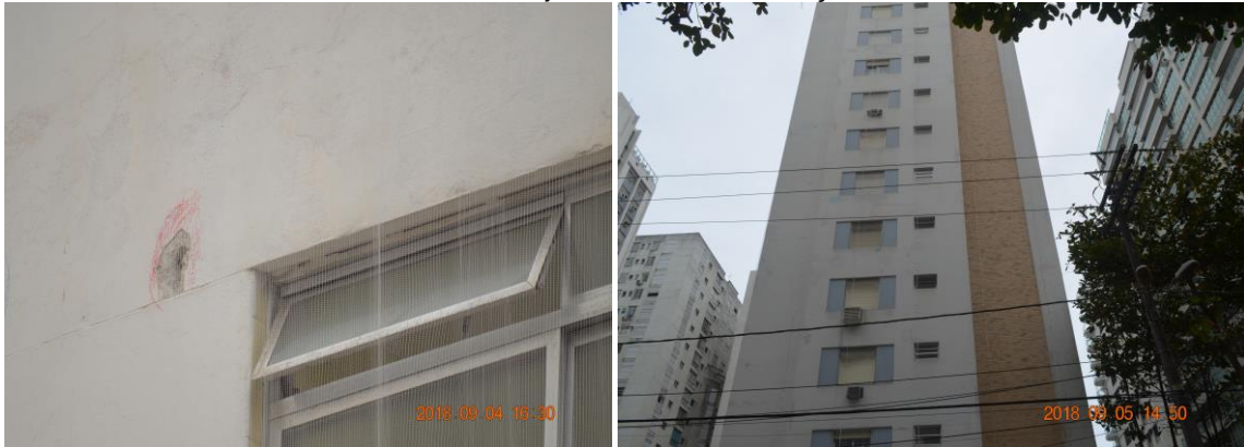
Figura 4 e 5 – Deslocamento do sistema argamassado e ausência de junta de movimentação e ausência de juntas de movimentação.
