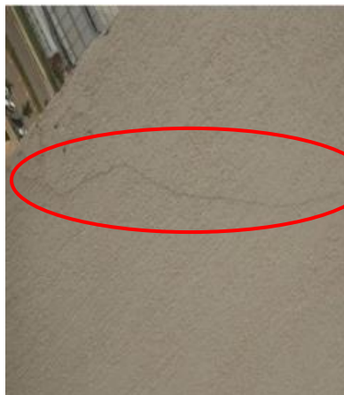
Figura 35_ Fissuras na região do balanço da laje (21º pavimento)
