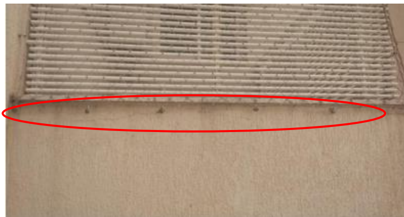
Figura 37_ Fissura na região da requadrção inferior da janela (9º pavimento)
