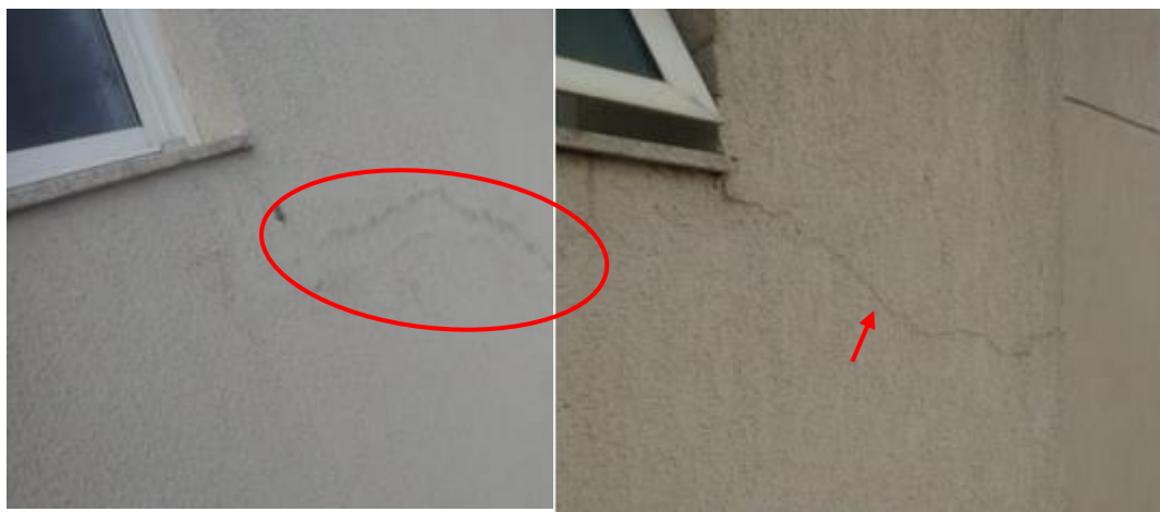
Figura 34_Fissuras nas extremidades das janelas
