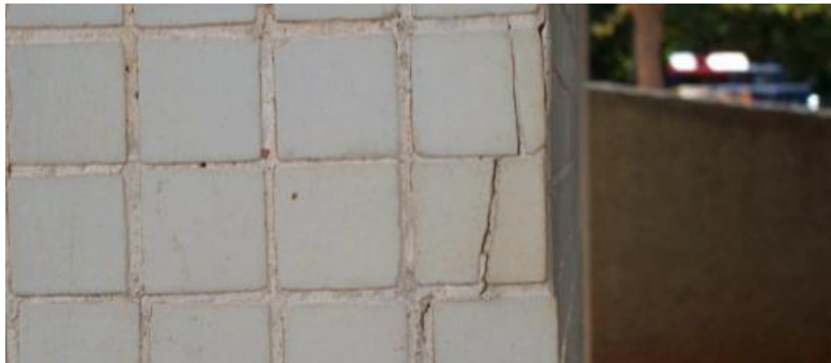
Figura 54_Fissuração do rejunte
