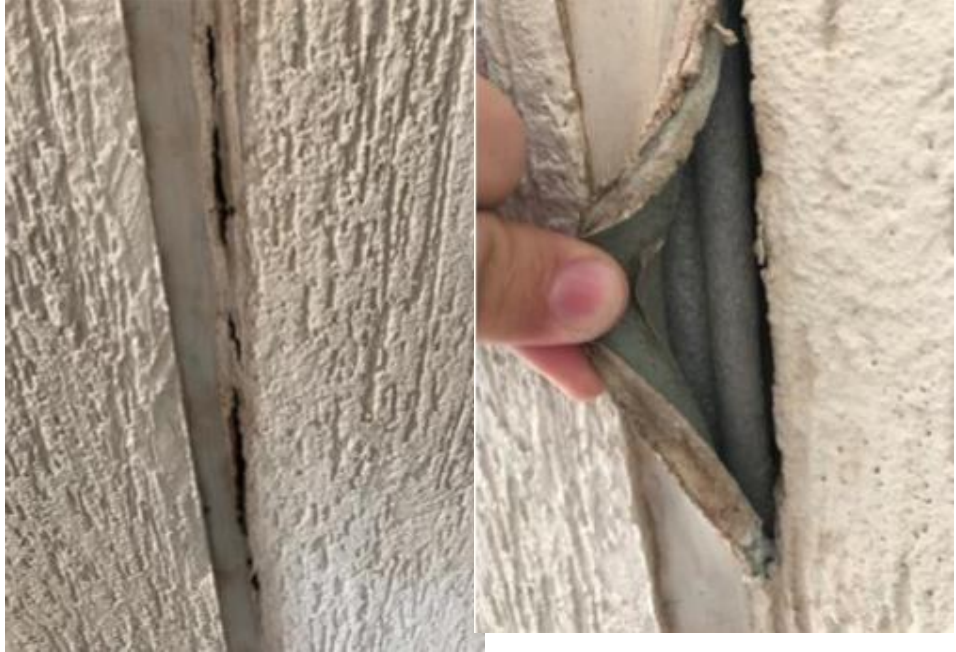
Figura 42_Selante da junta de movimentação rasgado devido a falhas na execução
