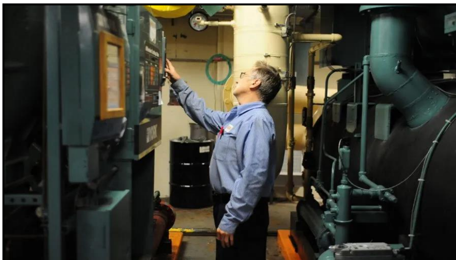
Figura 19 - Foto do sistema de climatização do Empire State
