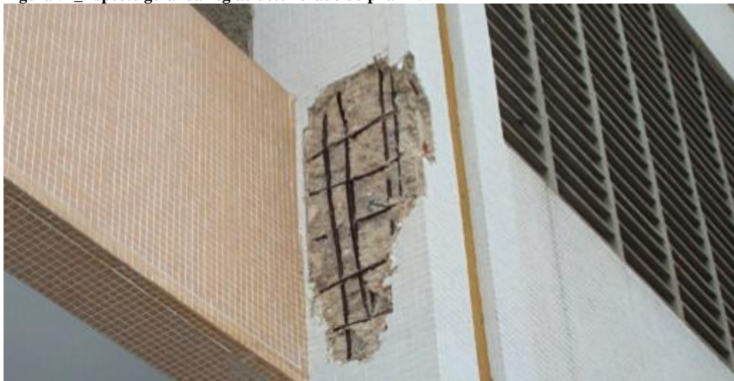
Figura 52_Aspecto geral da região deteriorado do pilar P5
