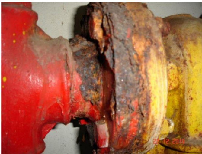
Figura 4 – Tubulação de SPK com corrosão avançada causada
