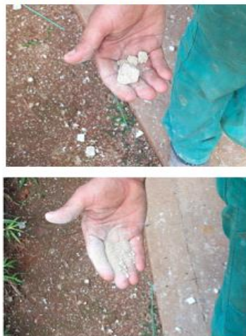
Figura 2 Constatação da baixa resistência mecânica do emboço retirado do pilar P30
