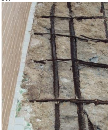
Figura 51_Flambagem longitudinal (pilar P5)
