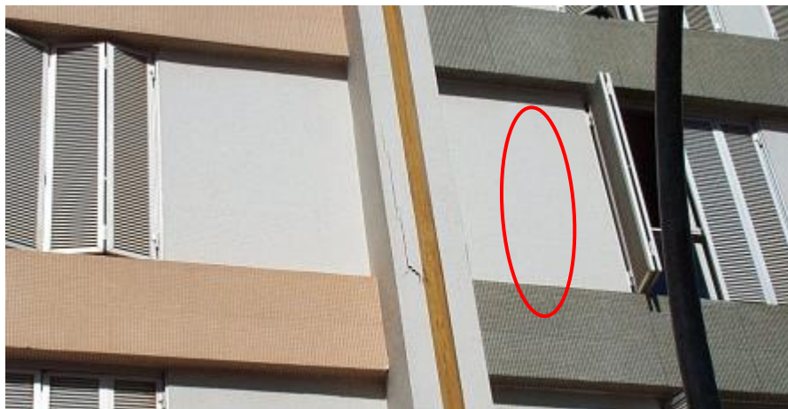
Figura 47 Deslocamento do revestimento cerâmico sobre um dos pilares que compõem uma das juntas estruturais do prédio
