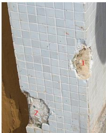
Figura 1 Aspecto de duas regiões vizinhas do pilar P30, que apresentaram diferentes resistências de argamassas de emboço
