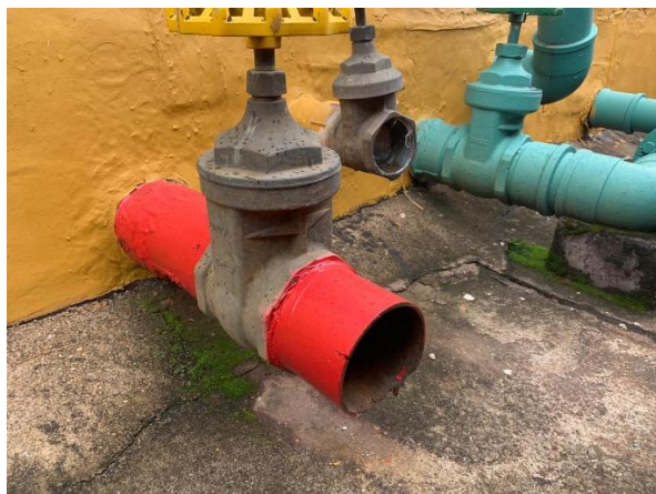
Figura 11 - Recorte inadequado (extravasor).
