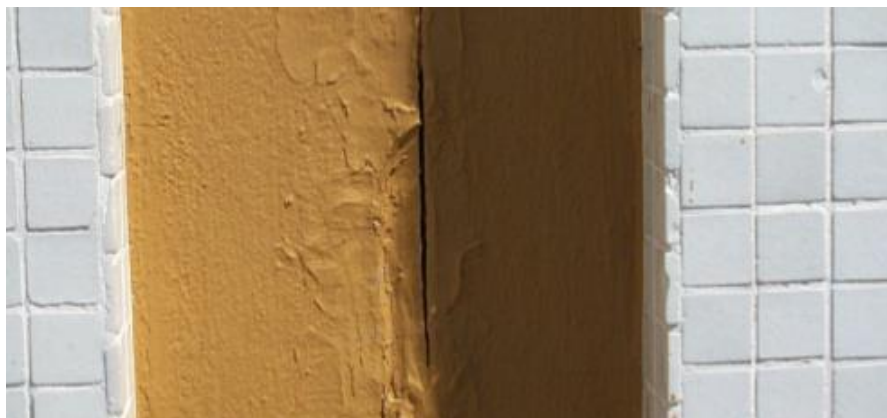
Figura 55_Fissuração no selante utilizado na junta estrutural do prédio
