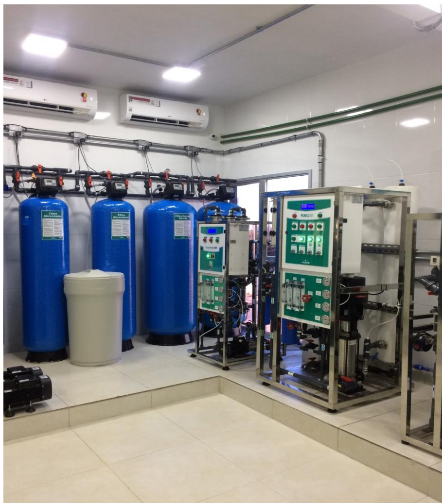
Figura 6 - Sala de tratamento d'água.
