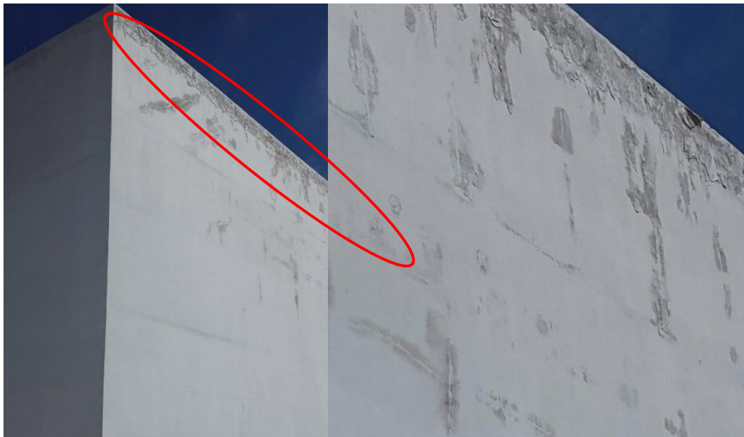
Figura 60_Descolamento do revestimento na região da platibanda
