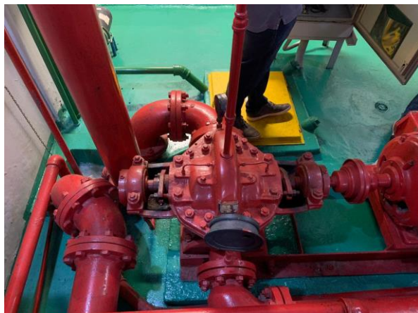
Figura 8 – Detalhe bomba elétrica principal com eixo desprotegido
