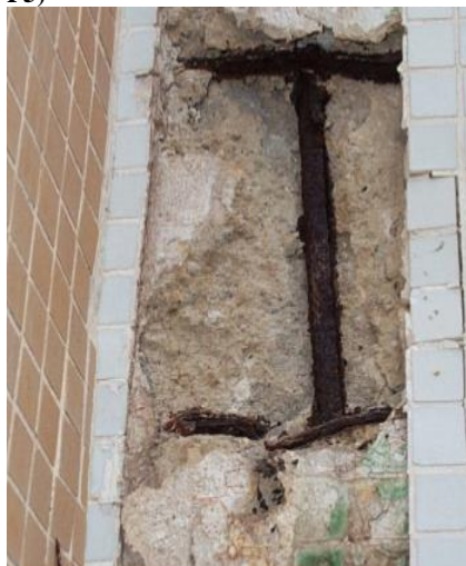
Figura 50_Rompimento de estribos (pilar P5)
