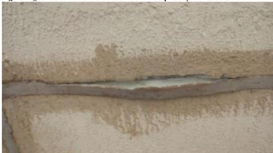
Figura 41 _Falhas de aderência do selante devido a presença de resíduos
