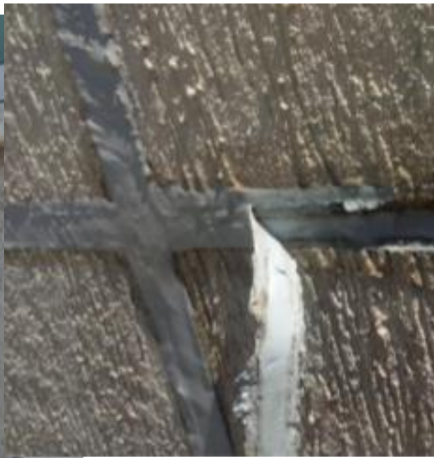
Figura 40 _Pequena espessura do selante propiciando o seu deslocamento
