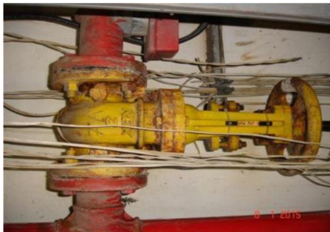
Figura 6 – Tubulação de SPK com corrosão avançada causada
