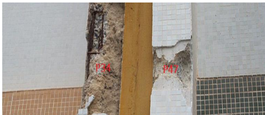
Figura 49_Aspecto da corrosão de armadura no pilar P34
