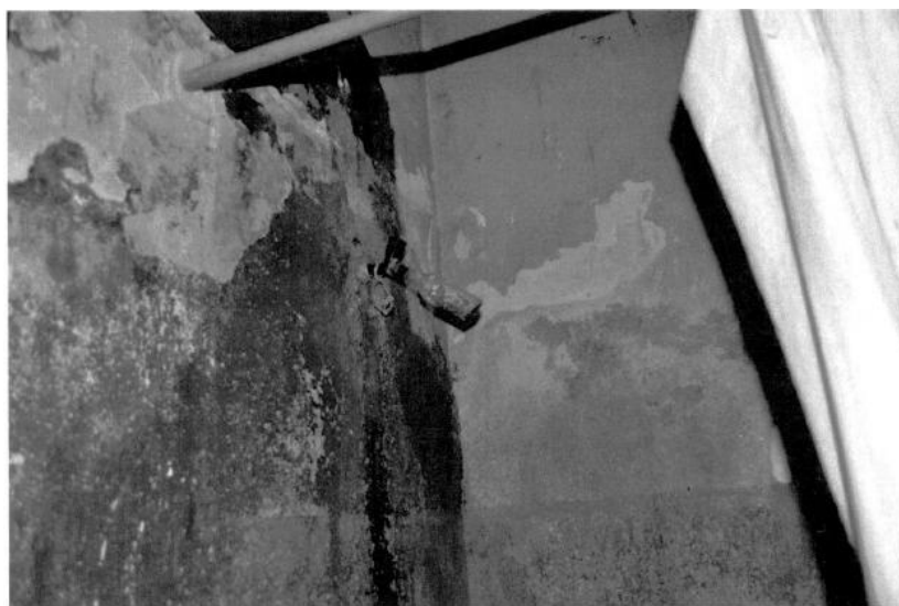
FOTOGRAFIA 3 – CDP, BLOCO 1, ALA A, CELA 8 – BANHEIRO DA CELA. ESTRUTURA DECRÉPITA E DETERIORADA. BOCAL DE CHUVEIRO IMPROVISADO. MESMA SITUAÇÃO OBSERVADA EM VISTORIAS DE 2015.
