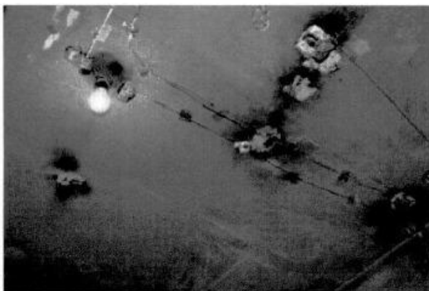
Fotografia 7 – Cella do Bloco 2. Fios condutores desprotegidos feitos pelos internos com metal proveniente das “quentinhas”.
