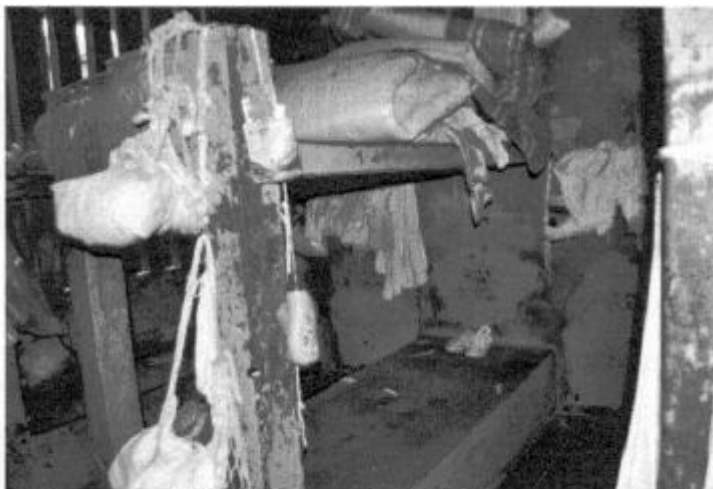
Fotografia 10 – Bloco 2, Ala C. Aspecto geral de cela. Pintura desgastada.
