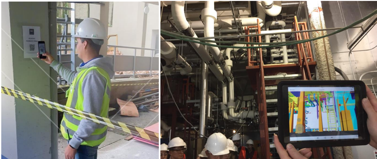
Figura 91 - Colaborador da RAC Engenharia utilizando o QR Code em obra e, à esquerda, imagem disponibilizada por Leite, (2019) demonstrando a utilização do modelo BIM para visualização 3D da obra.
