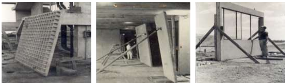
Figura 10: Colina, painéis modulados de cobogós, vedação e esquadrias, Lelé Acervo Universidade de Brasília
