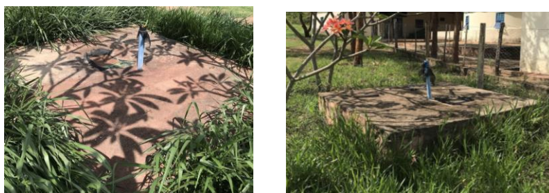
Figura 6. Duas fossas de tratamento de esgoto
