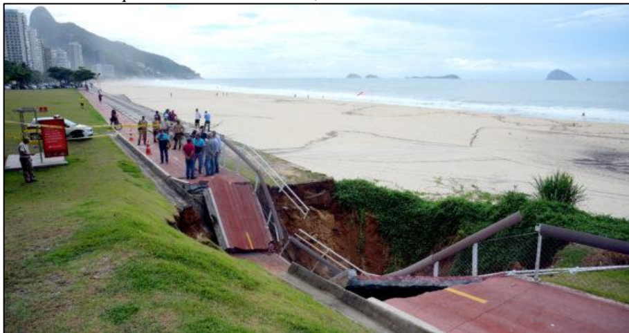
Figura 6 - Trecho da ciclovia Tim Maia desabou (São Conrado). Trecho da ciclovia Tim Maia que desabou na manhã da quinta-feira de 15/02/2018, em São Conrado. Não houve feridos.
