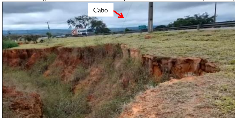
Figura 31 - Poste de energia com seu cabo de sustentação na beira de um barranco provocado pela erosão.
