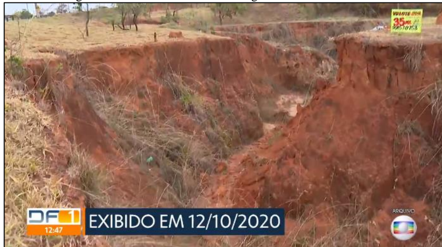
Figura 30 - Estado da erosão às margens da DF-250 em 2020.
