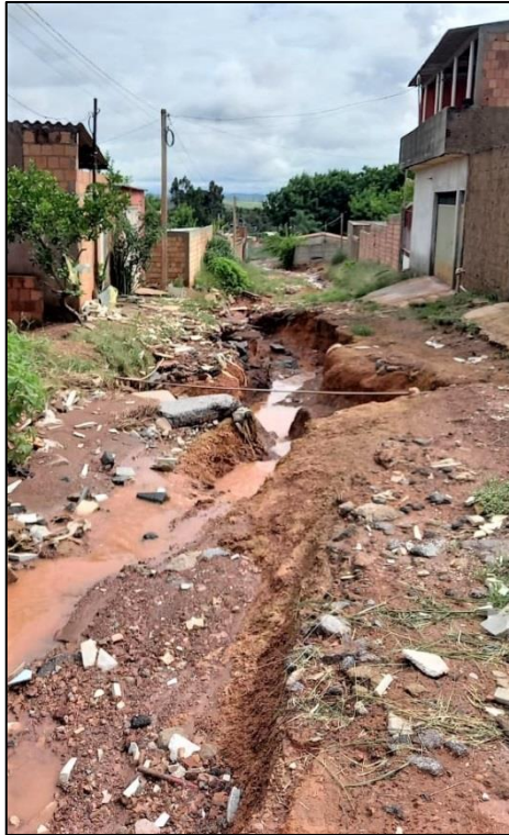
Figura 25 - Erosão no Capão Comprido, em São Sebastião, DF.
