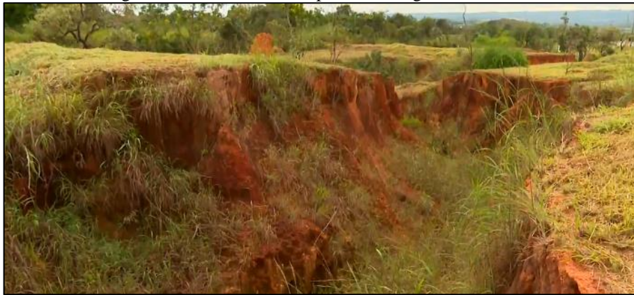
Figura 29 - Erosão, vista de perto, às margens da DF-250.
