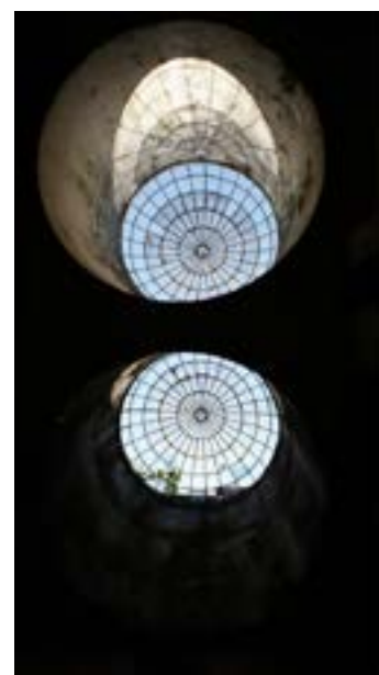
Figura 23- Detalhe Iluminação Estúdio, Pindú
