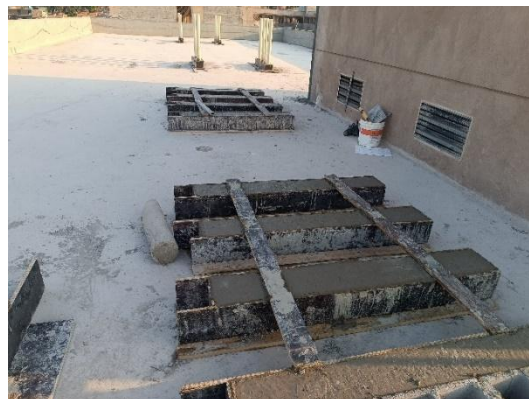
Figura 8: Base dos boilers
