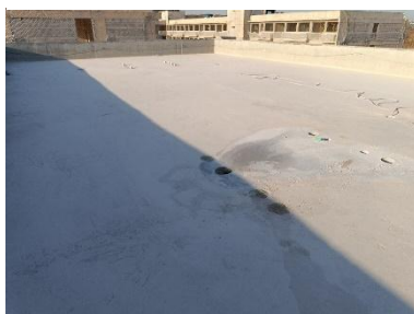
Figura 2: Laje após lixamento
